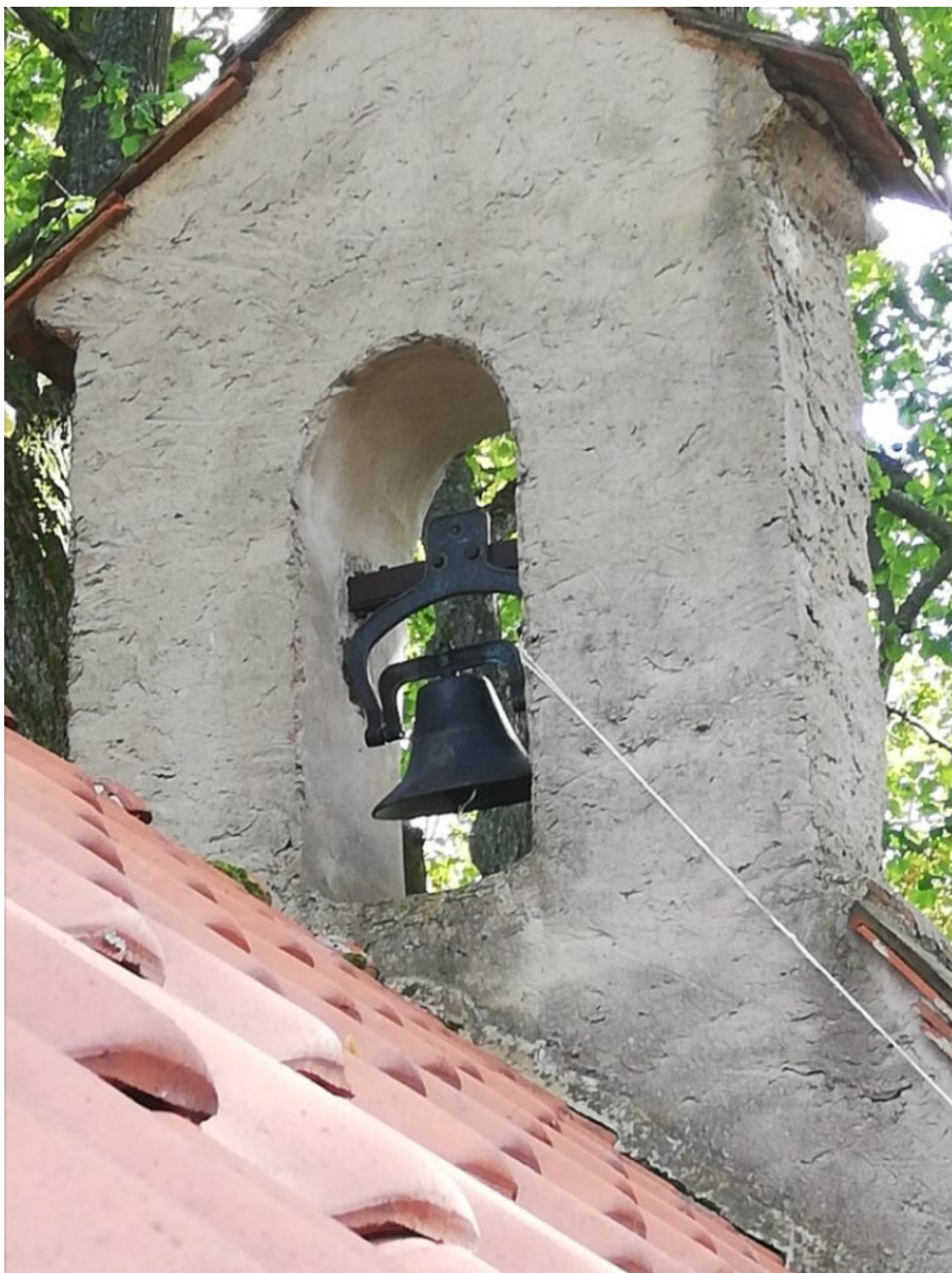
zvon zavěšený ve zvoničce ovládaný lanem
